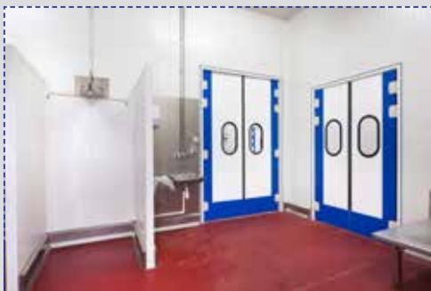
PolySto OP20F Inox installée sur un sol en béton
