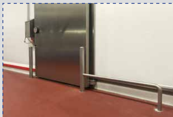
PolySto protections tubulaires inox scellées dans le sol.
