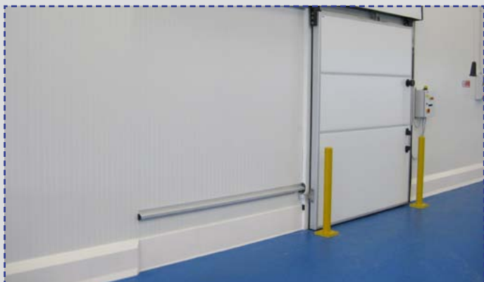
Sanicoat sokly PolySto OP305F a polyuretanové ochranné sloupky na epoxidové podlaze.
