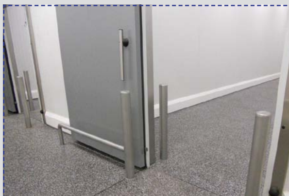
PolySto nerūdijančio plieno apsaugos ir barjerai, OP30RB Sanicoat grindjuostės su granito grindų danga.
