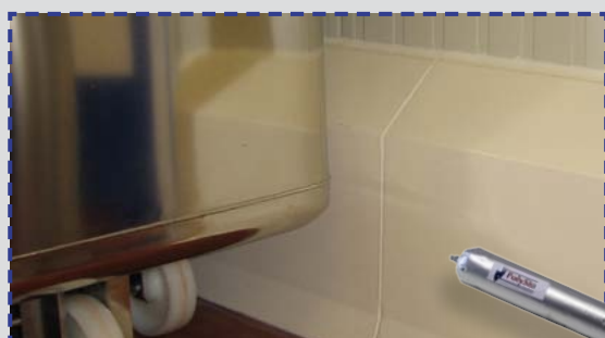
PolySto OP30F instalata pe o pardoseala deja realizata, finalizand cu rosturi agreate in industria agroalimentara.
