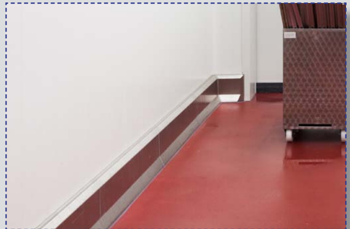
PolySto OP20F de aço inoxidável aplicado em pavimento de epoxy.
